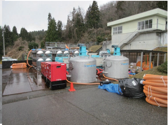
輪島市宝立浄水場の浄水ユニット トマ其
