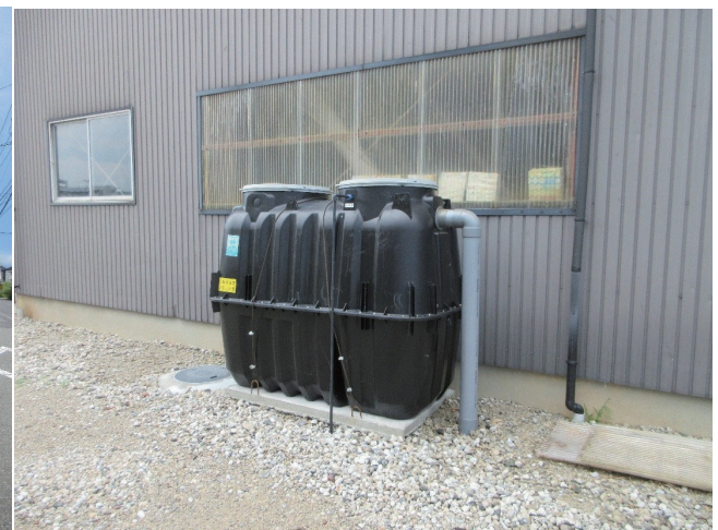
居住している住宅の外に設置された仮設浄化槽。
