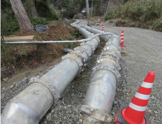
斜面道路に仮復旧された送水管・配水管。
