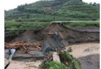
平成29年7月の豪雨により決壊（福岡県）
