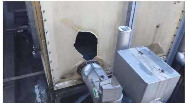
設備機器・タンクの破損
