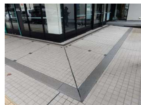
免震クリアランスを覆うパネル(せり上がり式Exp.J)
