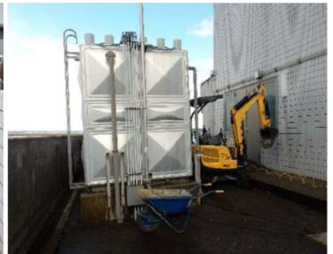
受水槽(中水)と建物とつなぐ 配管が沈下で破損 13
