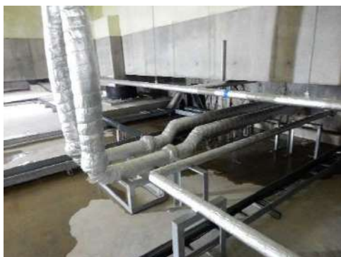
免震層の設備配管 (大きな変位にも配慮・無被害)
