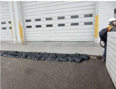
液状化による周辺地盤の沈下 (土嚢による補修)
