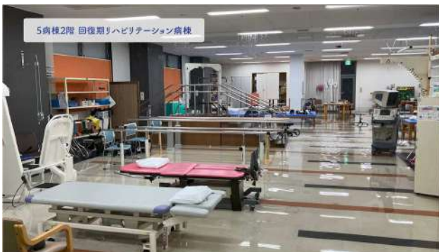
5病棟2階 回復期リハビリテーション病棟 配管の破損による漏水、天井板の落下など
