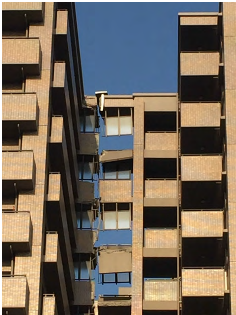
L字型に配置された二棟の中高層マンションのコーナー部分に 設けられたエキスパンションジョイントの破壊
