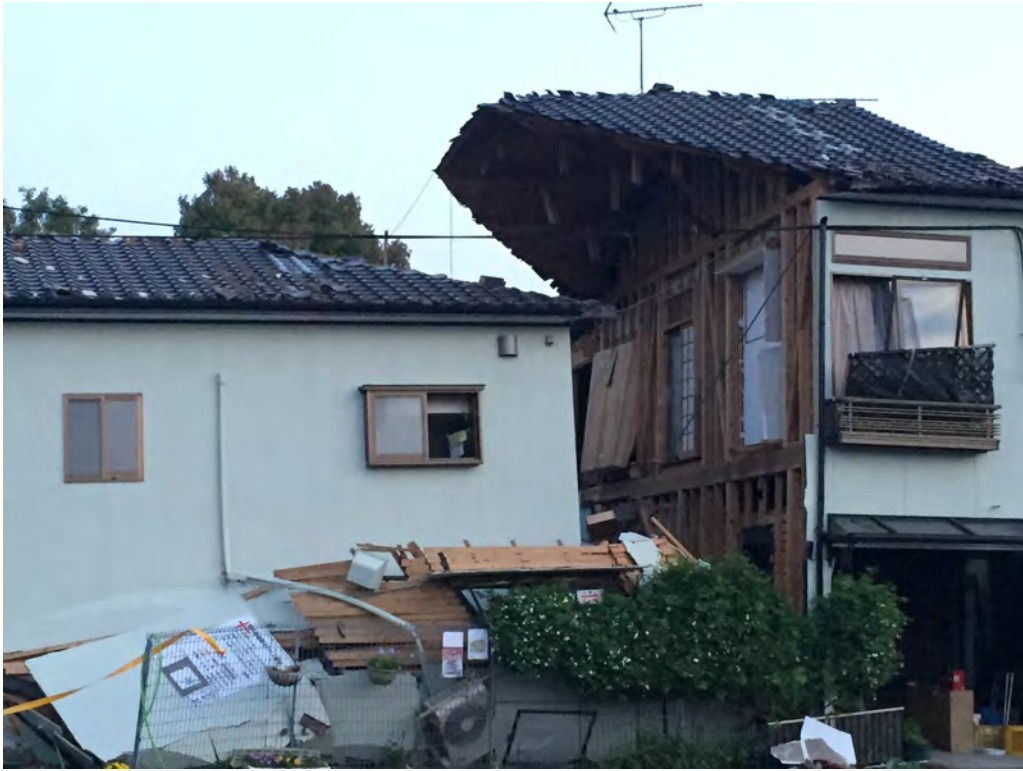
1階が完全に破壊した2階建て木造住宅の左側部分
