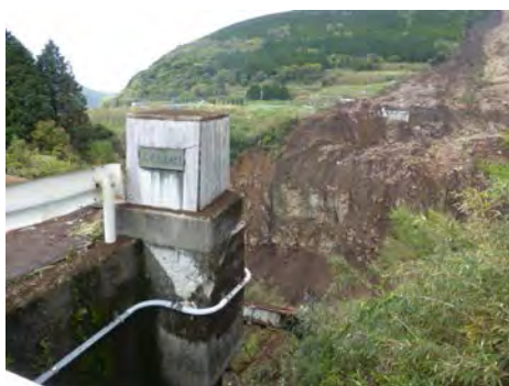
阿蘇大橋の被災状況. 土砂災害の影響大
