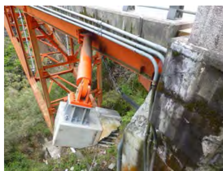
南阿蘇橋の被災状況(ダンパーの基礎が外れている). 地震動の影響大
